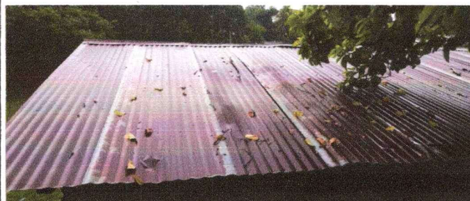
Foto 6: LAMINAS EN MAL ESTADO DE AULA
