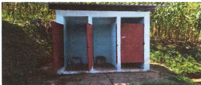
Foto 3: SANITARIOS EN MAL ESTADO
