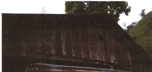
Foto 4: ESTRUCTURA DE TECHO DE AULA DE TERCERO EN MAL ESTADO
